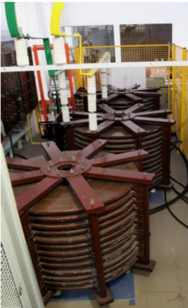
Dławiki zwarciove - element wyposażenia laboratorium do badania aparatury pracującej w układach elektroenergetycznych z lat 60 XX wieku
