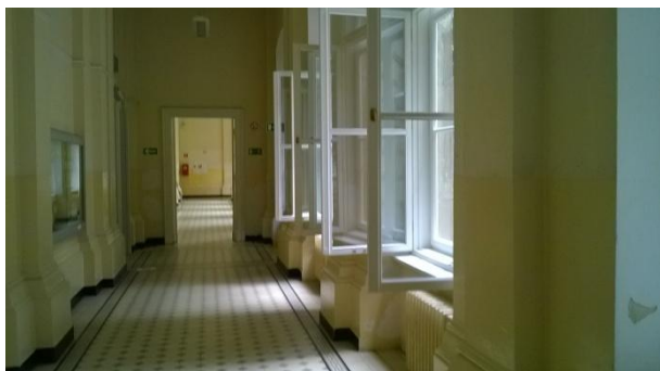
Fot. 11. Okna otwierane w stronę korytarza bez zabezpieczeń dla osób niewidomych
