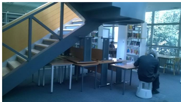
Fot. 14. Biblioteka pomiędzy poziomami 2a a 3 – brak zabezpieczenia spodniej strony biegu schodów
