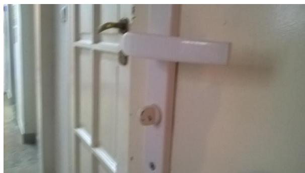
Fot. 18. Toaleta dla osób z niepełnosprawnościami – zamek utrudniający zamykanie toalety osobom z niepełnosprawnościami manualnymi
