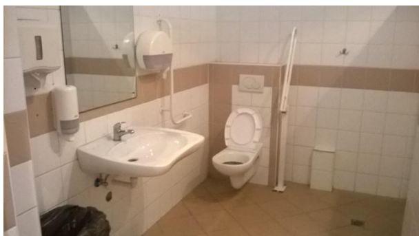
Fot. 17. Toaleta dla osób z niepełnosprawnościami – zbyt wysoko umieszczony papier toaletowy, lustro, ręczniki oraz haczyk
