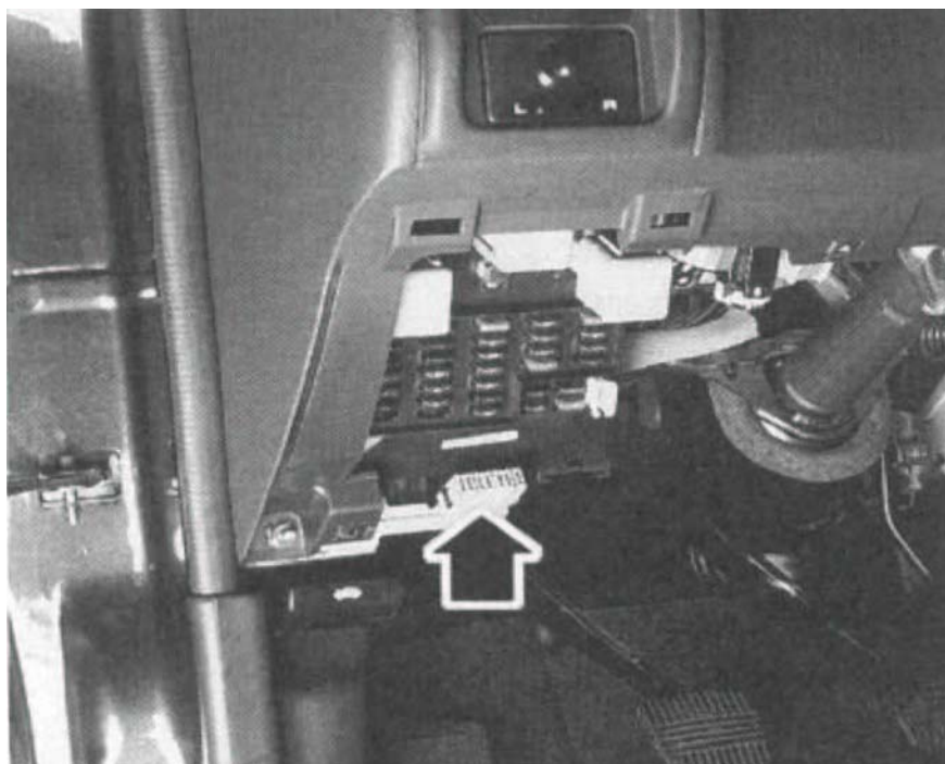
Rys 3.4 Usytuowanie złącza diagnostycznego
