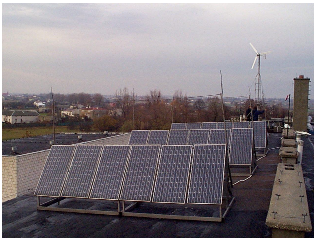
Rys.3.15. Elektrownia słoneczno-wiatrowa w Makowcu.
