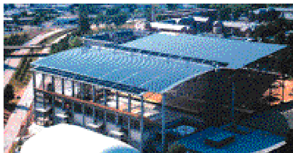
Rys. 3.7. System zainstalowany na dachu kompleksu basenowego na terenie politechniki w Georgii. System jest dołączony do sieci, składa się z 2832 modułów firmy Solarex (3043 m 2 powierzchni), a moc szczytowa jest równa 340 kWp.
