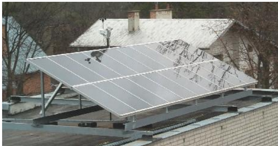
Rys. 3.14. System fotowoltaiczny zainstalowany na dachu Szkoły Podstawowej w Falenicy.
