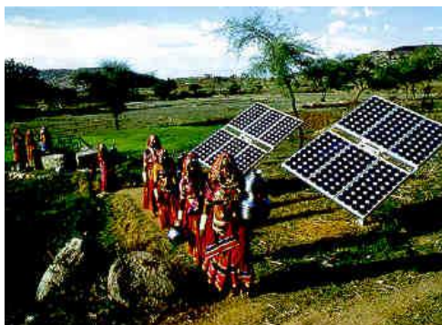
Rys. 3.1. Panele fotowoltaiczne w Pargula Thanda - Indie
