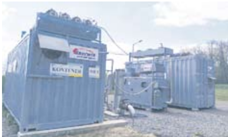
Innowacyjna stacja oczyszczania i sprężania gazu pokopalnianego
