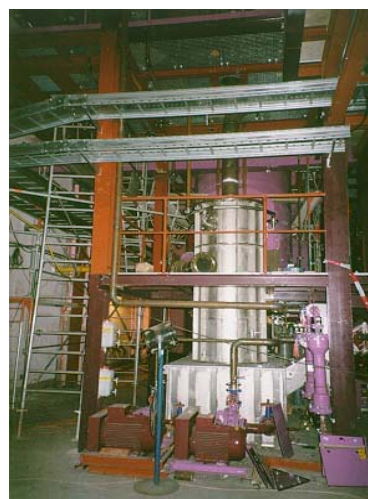
Rys 16. Widok zew. reaktora wysokotemperaturowego [30].
